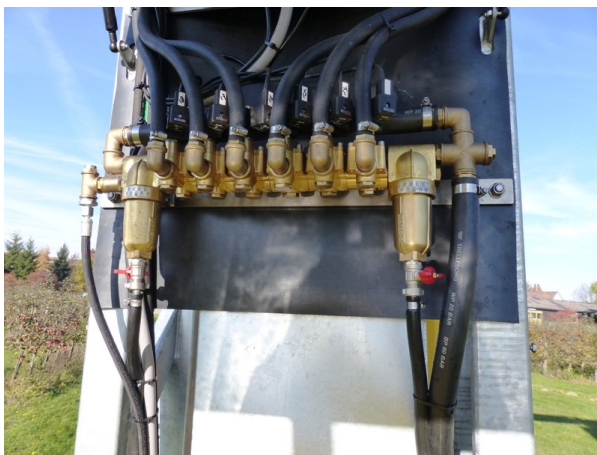
Abb. 18: Die elektromagnetisch schaltenden Teilbreitenventile sind unter einer Abdeckung am Gebläseträger platziert.
